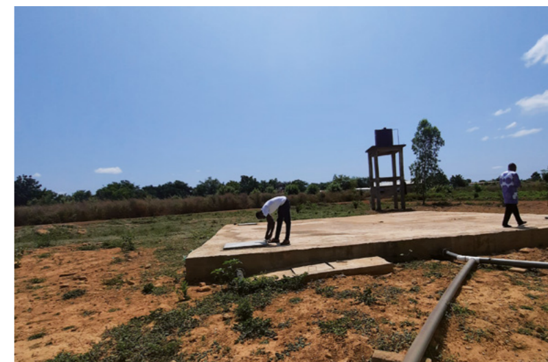
Das Wasserreservoir – Ein wichtiger Baustein in der Vorsorge: im Wassertank wird Regenwasser aufgefangen und für trockene Zeiten gespeichert.
